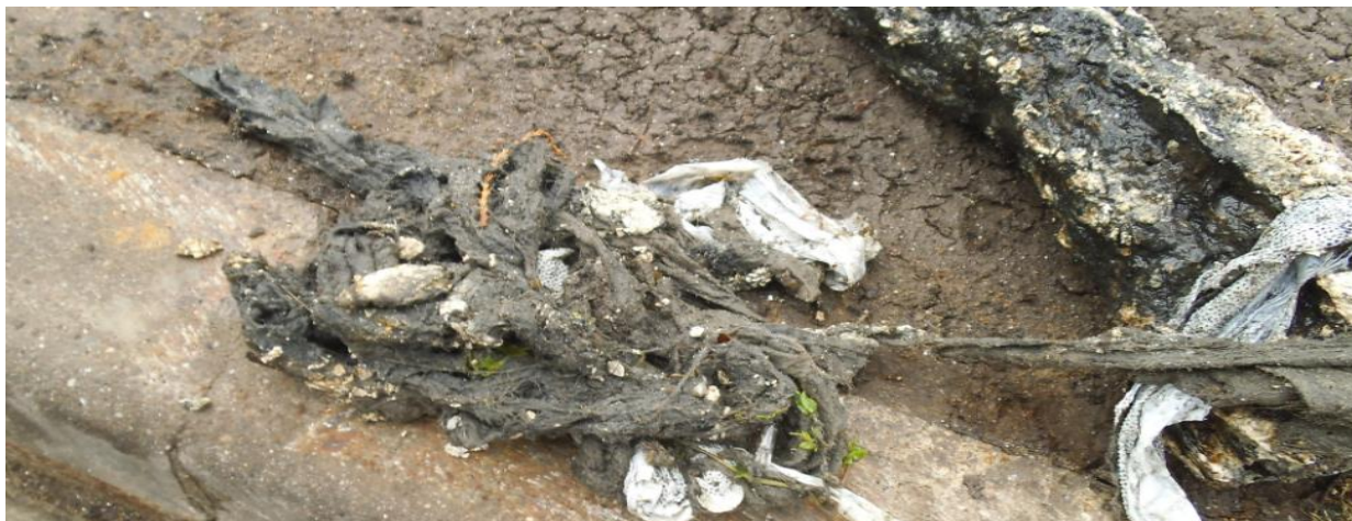
zdjęcie nr 1 – chusteczki nawilżające, ręczniki z materiału tekstylnego oraz tłuszcz (zator na sieci kanalizacyjnej w Strzeszowie)
